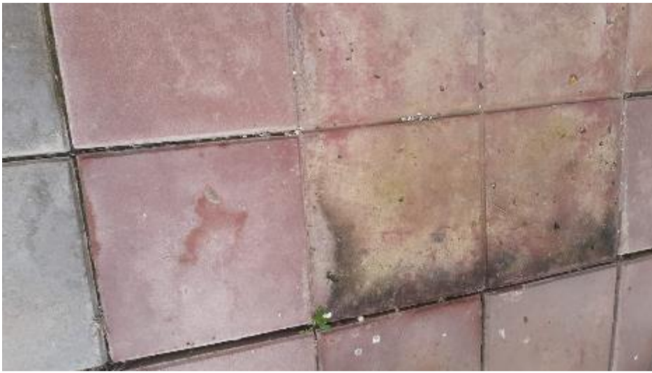
Pisos irregulares mal estado
