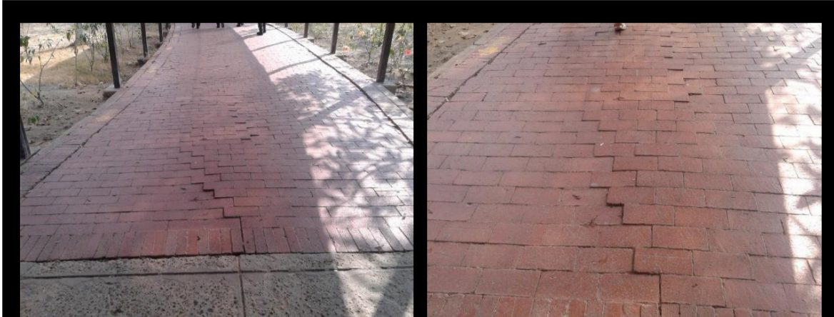
Riesgo locativo al ingreso de Ternera, sin demarcación
