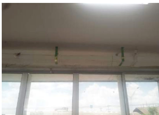
Instalaciones eléctricas sin seguridad
