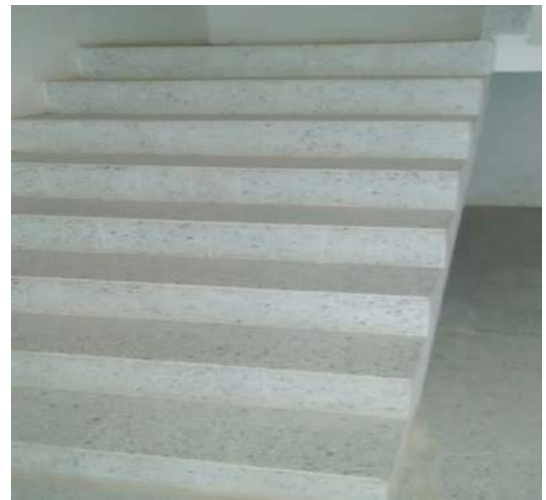
Escaleras sin pasamanos
