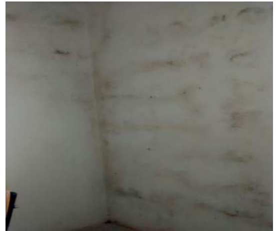
Paredes con humedad
