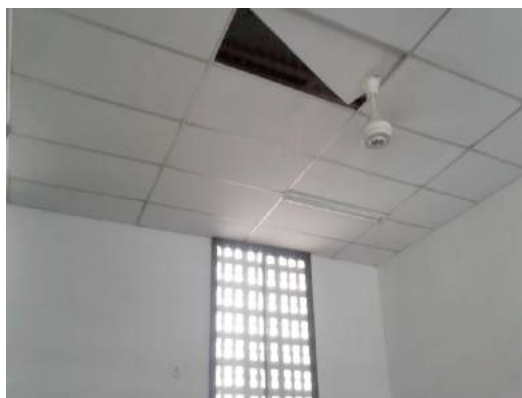
Techos falsos en mal estado
