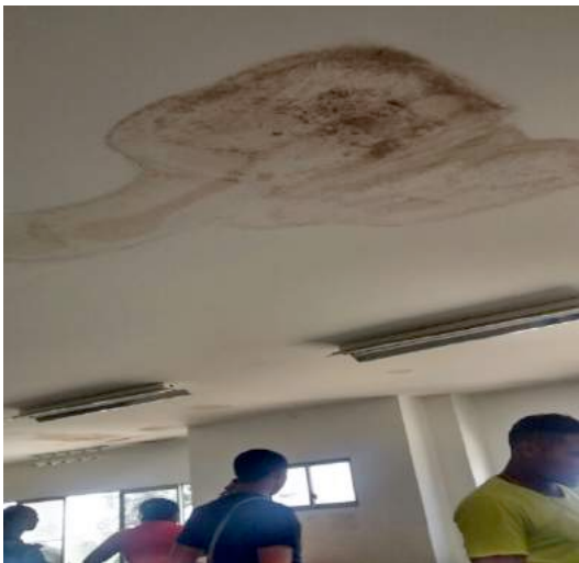
Techos con humedad
